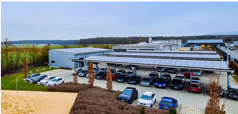
Abb. 2: Neue Photovoltaik-Anlage über Parkplatz, InnoSenT
