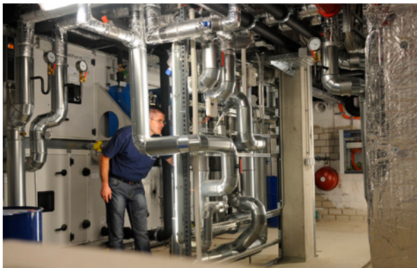
Energieeffizienter Betrieb der Klimaanlage
