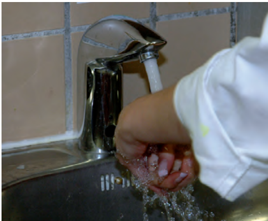
Schnell, sparsam und hygienisch – berührungslose Armaturen in der Küche des Klinikum Schwabing
