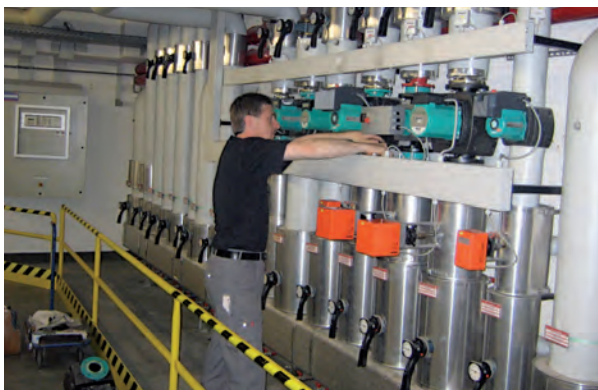
Baur-Techniker wechselt eine unregelmäßig gegen eine geregelte Heizungspumpe aus – 30 weitere folgen in Kürze.
