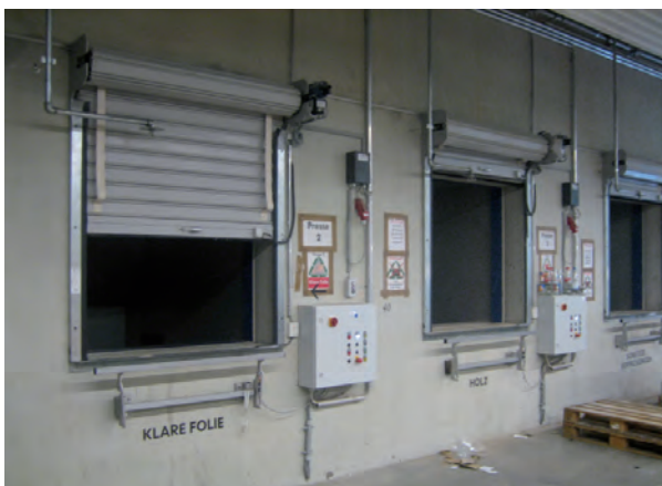
Wertstoffcontainer stehen im Hof und können von innen befüllt werden. Rolltore schützen vor Wärmeverlust.
