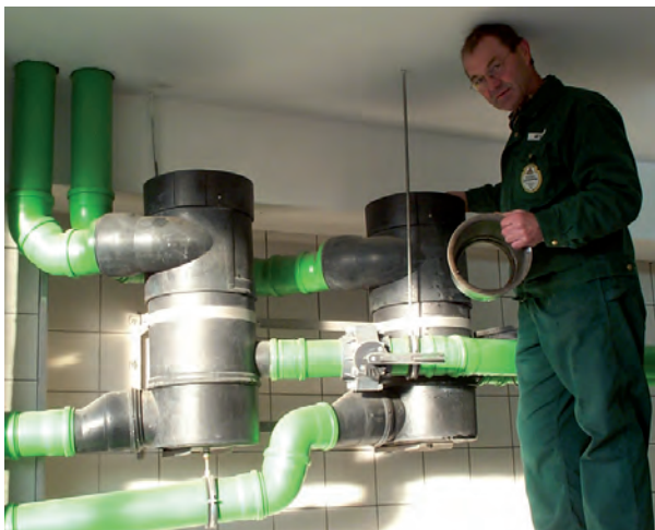
Blick auf die Filteranlage
