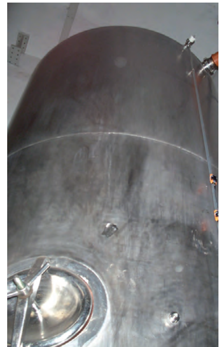
Gebrauchter Edelstahltank für das Regenwasser
